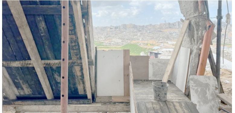
Een houten trap gebouwd door Hamza Salha en zijn familie om toegang te krijgen tot de bovenste verdiepingen van hun beschadigde huis in vluchtelingenkamp Jabalya. Mei 2025.
